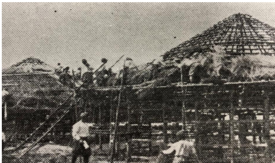
▲「日輪舎」～戦後は青年学校の校舎として使用された ※設計図(下図)を基に昭和18年の秋～春にかけて総て生徒の手によって建設された。
