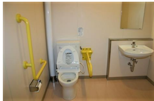
▲豊北農村生活センター多目的トイレ 「多目的トイレの計画的な設置を」
