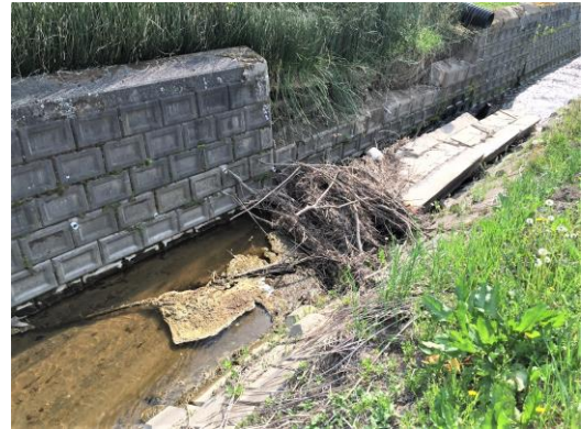
▲ポントペンピラウシナイ川 老朽化した積ブロック護岸の倒壊 「市民の安全安心のために」
