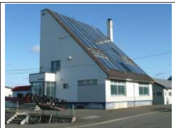
老朽化が著しい市営浴場
