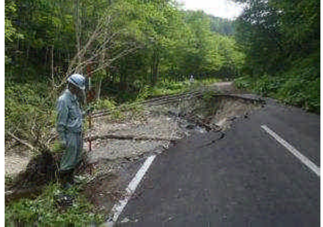
②路体消滅（国道 39 号線から約 9.9 km 地先）
