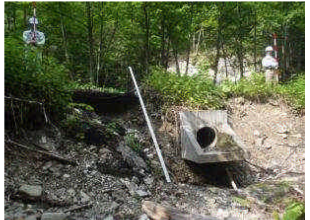
④路肩崩壊（国道 39 号線から約 8.9 km 地先）
