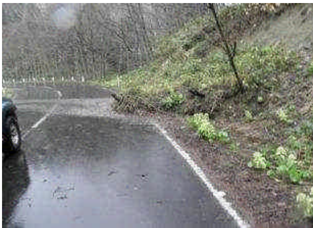
③法面崩壊（国道 39 号線から約 9.7 km 地先）
