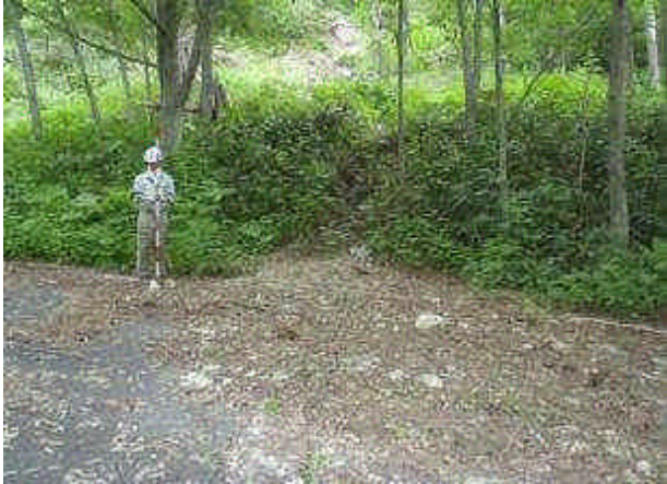
①法面崩壊（国道 39 号線から約 11.9 km 地先）
