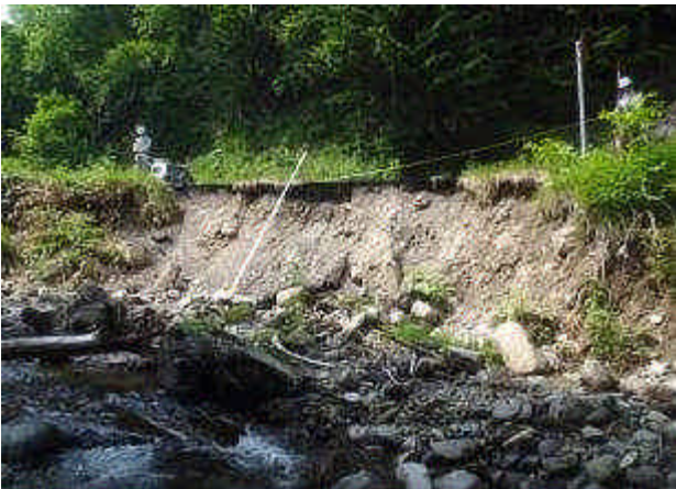
⑤路肩崩壊（国道 39 号線から約 8.6 km 地先）
